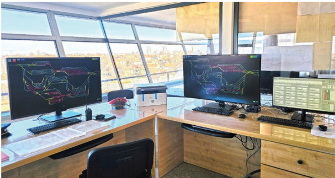
Слика 2 - Изглед станичне поставнице на радном месту унутрашњег оператера сигнално-сигурног уређаја
