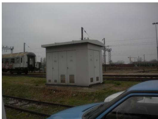
9. Трафо станица 24/1,7kV ИСПРЕД ГАРАЖЕ САЛОНА - измештена
